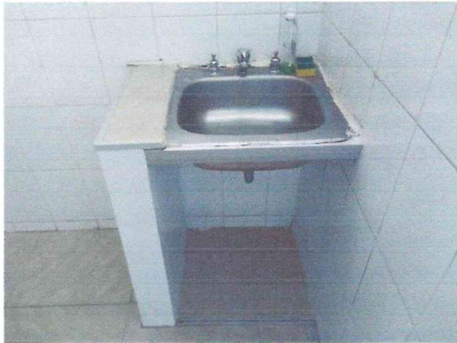
Foto 7. Se aprecia un lavadero improvisado y en mal estado.
