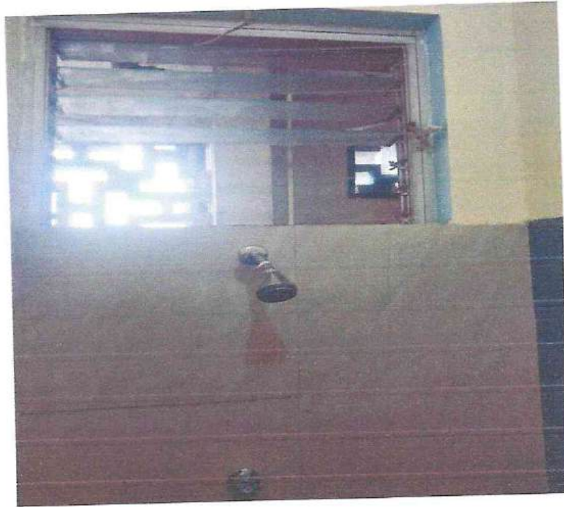
Foto 33. Se puede apreciar la ventana del baño deteriorada.
