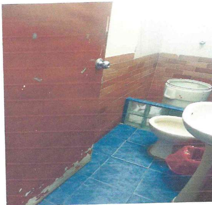
Foto 34. Se puede observar el baño en estado de deterioro.
