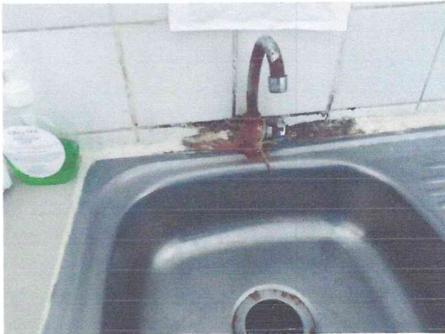
Foto 12. Se puede observar el mal estado del lavatorio para uso del personal médico, en el recorrido encontramos manchas en las paredes pisos deteriorados,
