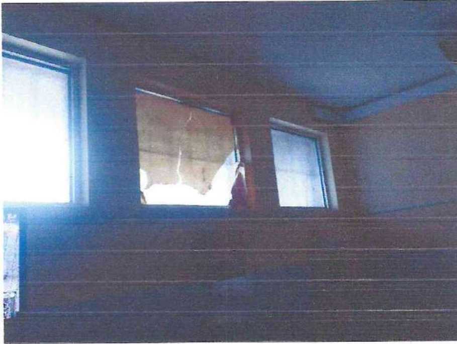
Foto 11. Se observa las ventanas de vidrio simples y deterioradas,
