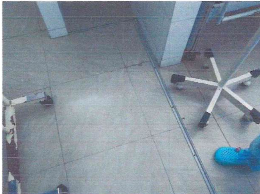
Foto 8. Se aprecia los pisos y mayólicas desgastadas.
