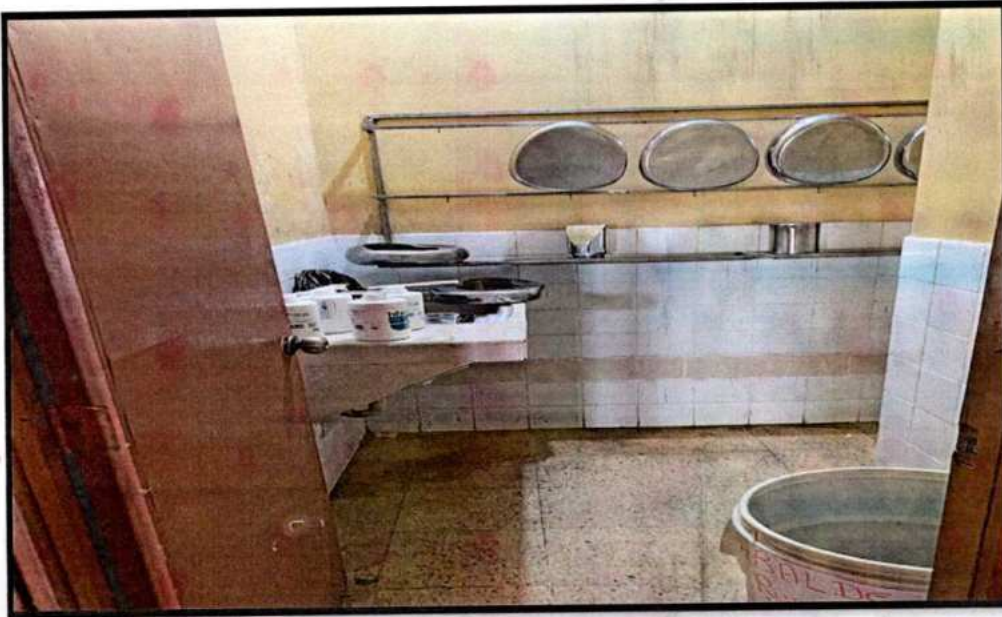
FOTO N°03: SE REQUIERE UNA PUERTA VAIVEN PARA EL AREA DEL CUARTO SUCIO.
