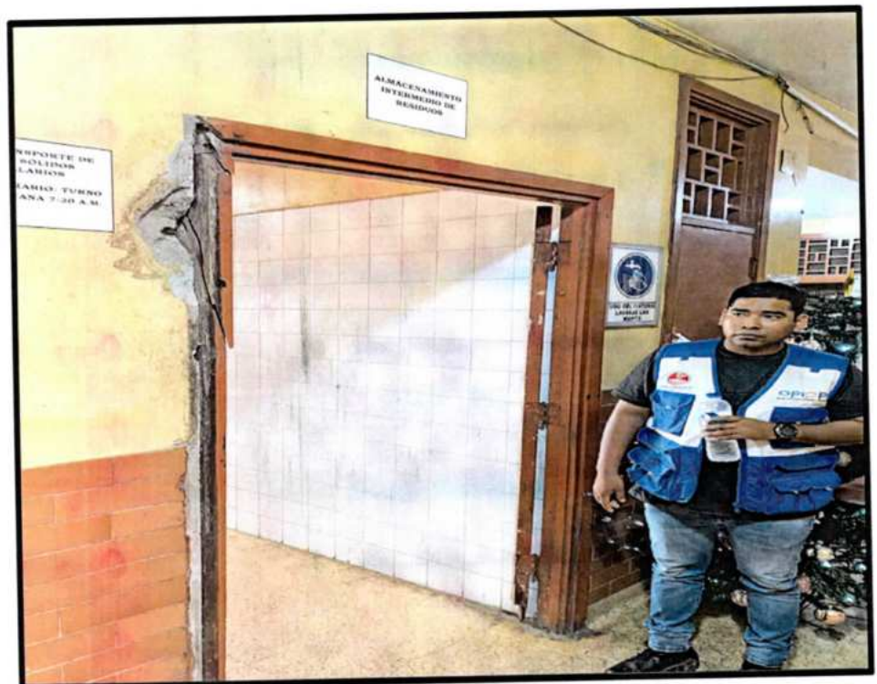
FOTO N°08: SE DEBE APLICAR DERRAME EN LAS PUERTAS QUE PRESENTAN FISURAS O ESTEN EN MAL ESTADO
