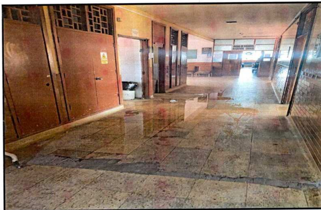
FOTO N°05: LAS CONEXIONES DE RED DE AGUA NECESITAN SER VERIFICADOS POR UN ESPECIALISTA ANTE LAS FUGAS
