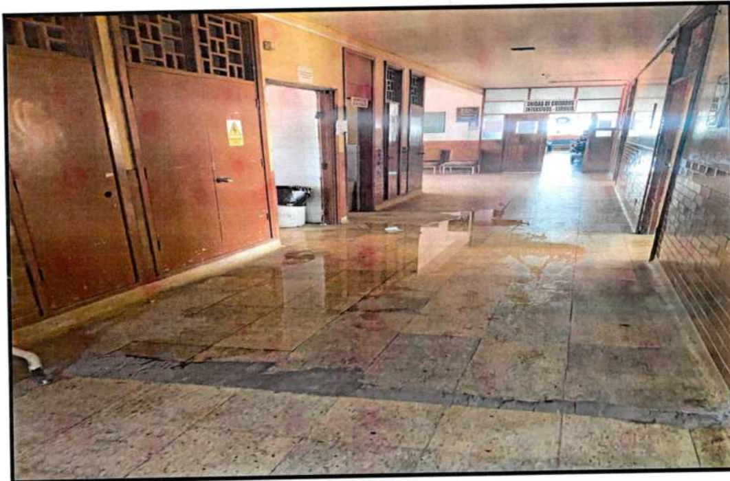
FOTO N°05: LAS CONEXIONES DE RED DE AGUA NECESITAN SER VERIFICADOS POR UN ESPECIALISTA ANTE LAS FUGAS
